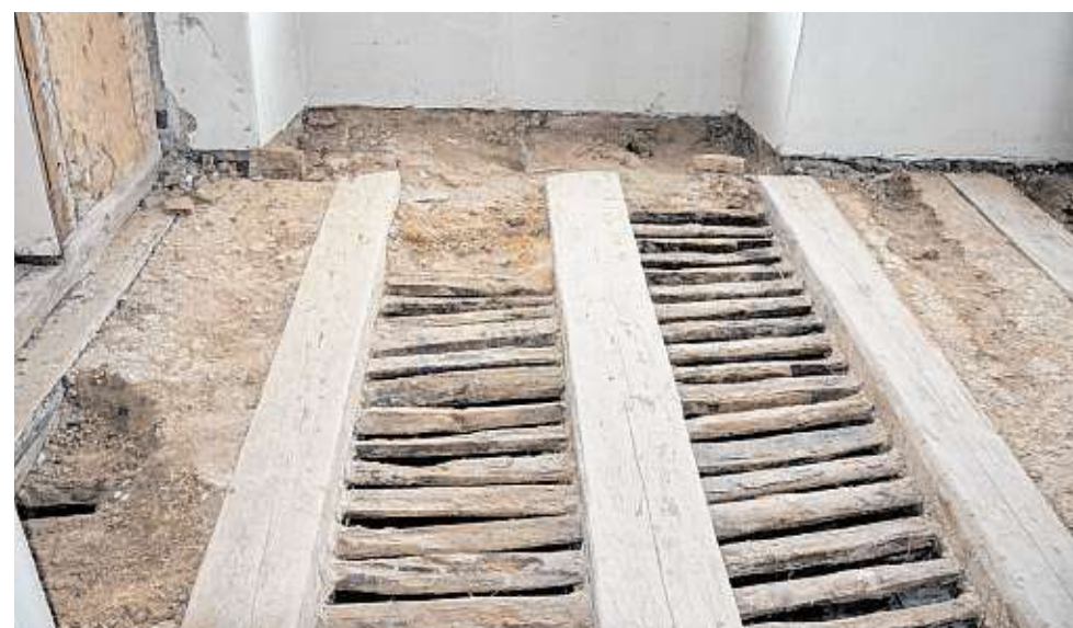
Im Südflügel des ersten Obergeschosses ist der Wasserschaden am größten. Der Boden liegt fast vollständig offen, so dass man die Deckenkonstruktion sieht. FOTO: JESSICA LÜCK
